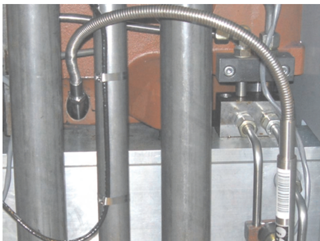
Fig. 4. Installation place HTT-sensor Rys. 4. Zamontowany czujnik HTT
