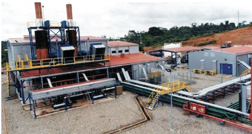
Fig. 4. Dygoil power plant powered by two Wärtsilä 16V32GD gas-diesel engines Rys. 4. Elektrownia Dygoil zasilana przez dwa gazowe silniki o ZS Wärtsilä 16V32GD
