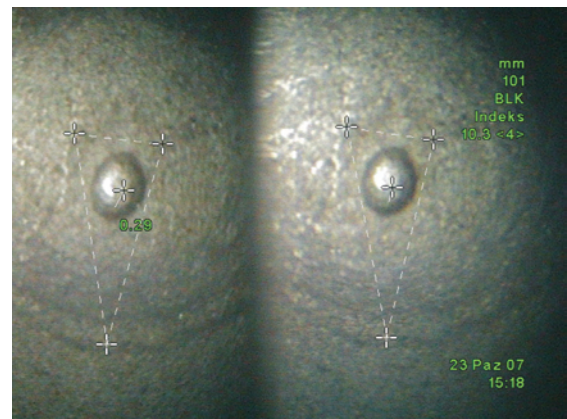
d) measurement of the surface protrusion of the bulge on vane surface – 0.29 mm, with accuracy index 10.3, which corresponds to 0.1 mm d) pomiar wypukłości „wypływu” powierzchniowego w korycie lopatki – 0,29 mm, przy indeksie dokładności pomiaru 10,3, co odpowiada 0,1 mm
